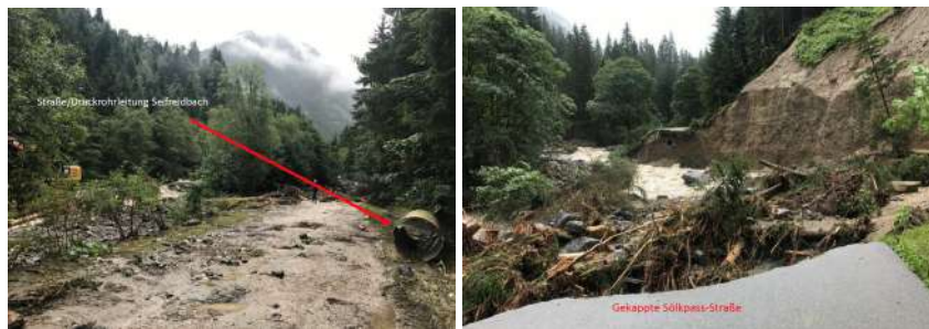
Abbildung 4: Fotos der Unwetterkatastrophe (lokale Starkniederschläge) von 4.-5.8.2017 im GroßsölktaI der Gemeinde Sölk, zerstörte Infrastruktur: Druckrohrleitungen der (neuen) Wasserkraftwerke des E-Werks Gröbming sowie verwüstete Straßen. © Ernst Trummer, E-Werk Gröbming
